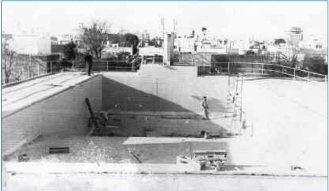
Construcción de la pileta de natación del Campo de Deportes de Ramos Mejía
